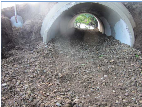
Keine Barriere mehr – Durchlass mit Kiessohle
