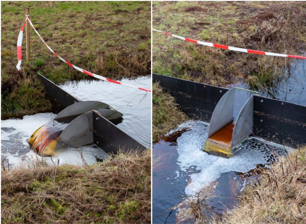
Abbildung 76: Suderburger Stauklappe (Hydraulisch gesteuertes Wehr) Bild links: Hydraulisch gesteuertes Wehr öffnet sich durch den absinkenden Unterwasserspiegel. Bild rechts: Hydraulisch gesteuertes Wehr vollständig geöffnet.
