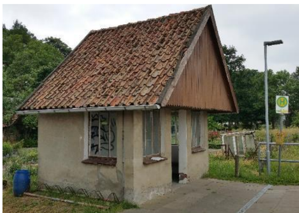
Abbildung 6: Vor der Sanierung
