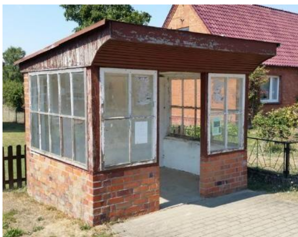
Abbildung 8: Vor der Sanierung
