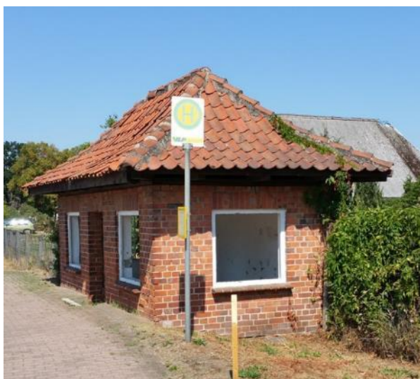
Abbildung 14: Vor der Sanierung
