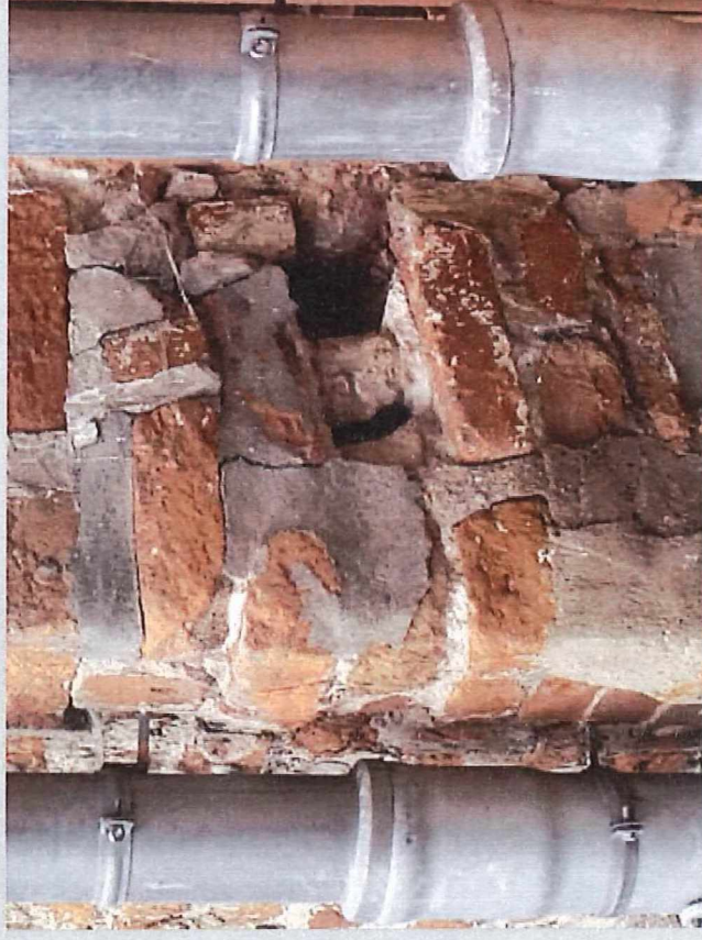
Schäden am Mauerwerk
