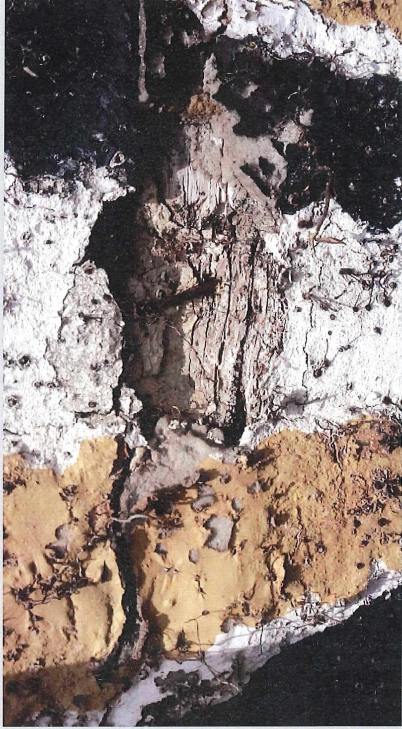
Abplatzen der Farbschichtungen
